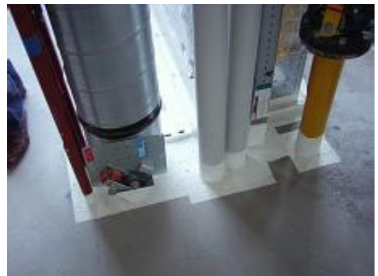
Foto 7: Leidingdoorvoeren door brandwerende scheidingsen (goed uitgevoerd)
