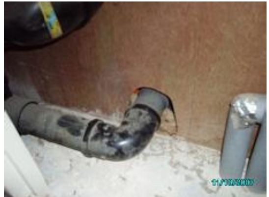
Foto 8: Onafgewerkte doorvoer in brandscheiding
