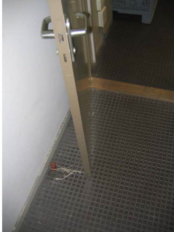
Vastgezette brandwerende deur
