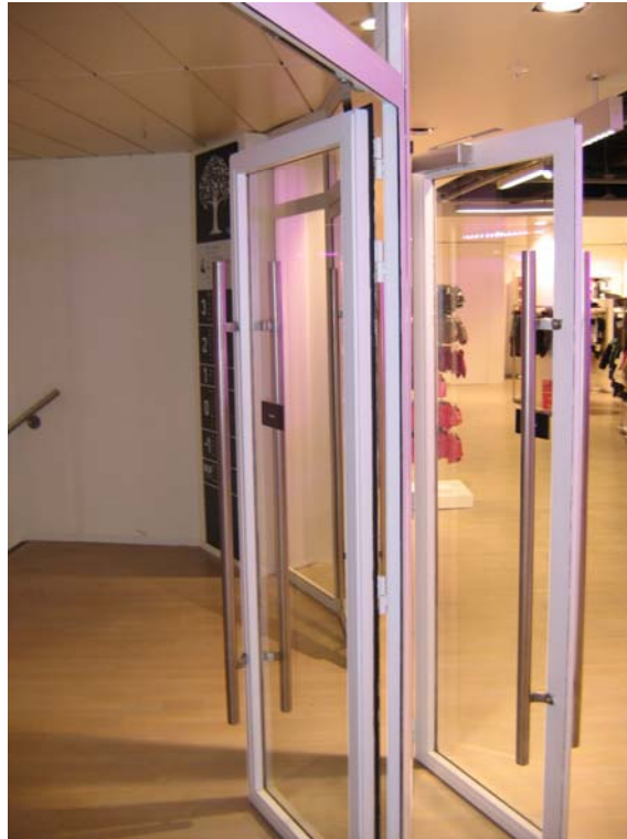
Brandwerende deuren met onklaar gemaakte drangers
